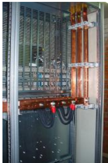
Рис. 3. Отсек сборных шин.
